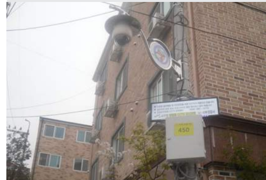
방범용 CCTV 카메라
