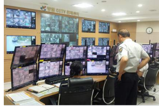
방범용 CCTV 관제센터
