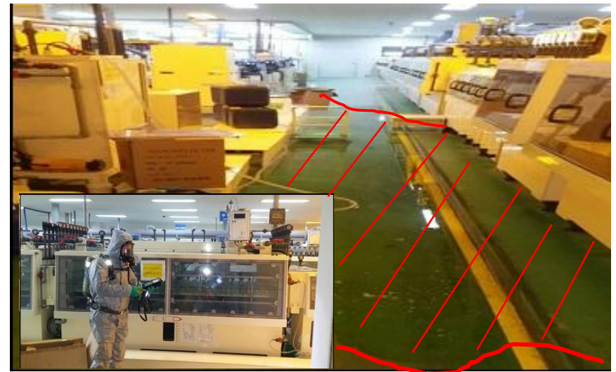
보조탱크 염산 역류로 유출(인명피해없음, '17.3.3(금))
